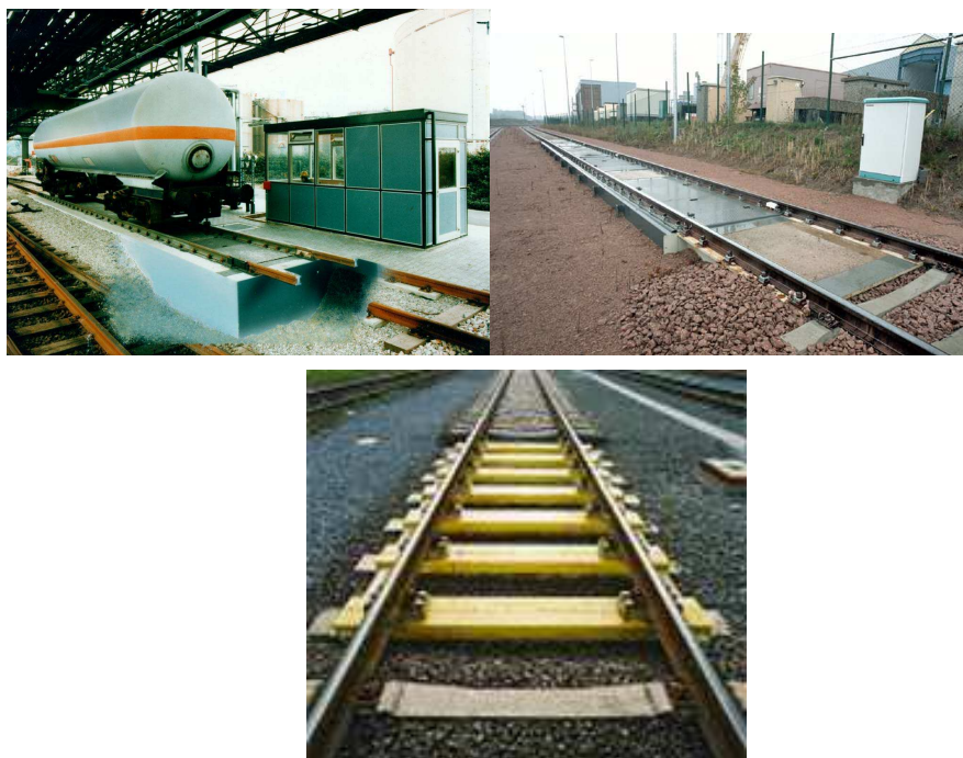
Fig. 2. The platform scales (top left), in the foundation tank (top right) and in the rail beams (bottom) Rys. 2. Wagi kolejowe pomostowe (u góry z lewej), w wannie fundamentowej (u góry z prawej) i w podkładach kolejowych (u dołu)
